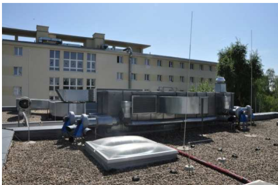
Obr. 1: Nezabezpečený světlík v těsné blízkosti prvků vzduchotechniky může ohrozit pracovníka při její údržbě
