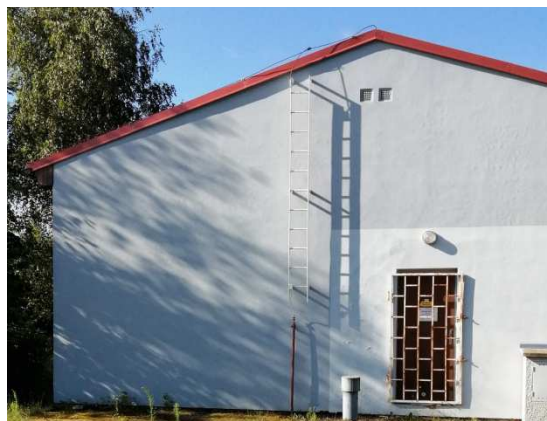
Obr. 6: Nedostatečný přesah žebříku sloužícího pro výstup na střechu
