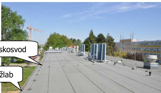
Obr. 4: Absence ochrany proti pádu pracovníků při čištění okapového žlabu či revizi bleskosvodů
