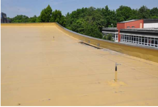
Obr. 9: Vzdálenost mezi kotevními body umožní pád před dosažením dalšího z bodů a padající osoba při pádu narazí na nižší část budovy dříve, než jej zachytí OOP
