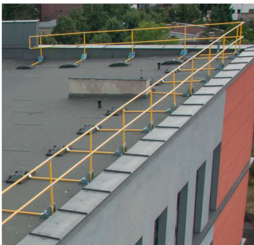
Obr. 12: Příklad zabezpečení střechy proti pádu použitím přenosného zátěžového zábradlí [26]
