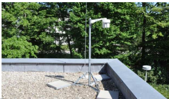
Obr. 3: Technologie, umístěná na nezabezpečeném okraji střechy, navíc vyžadující při činnosti zvýšení těžiště pracovníka
