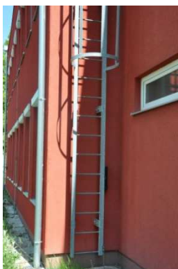
Obr. 7: Bezpečnostní koš začínající ve výšce 3,5 m
