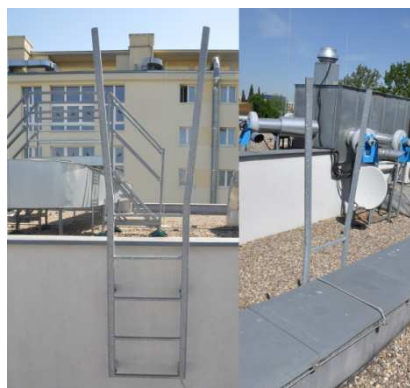
Obr. 8: Horní příčel žebříku přesahuje nad úroveň nástupní/výstupní úrovně
