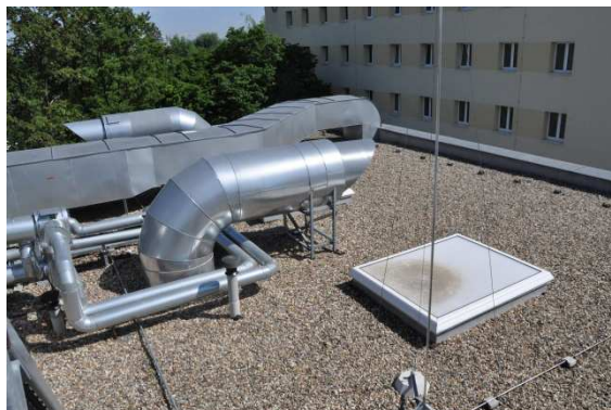
Obr. 2: Nezabezpečený světlík v těsné blízkosti prvků vzduchotechniky může ohrozit pracovníka při její údržbě
